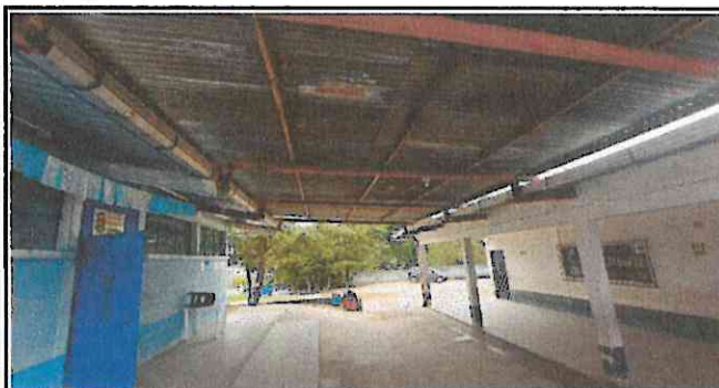
Foto 4: La estructura tiene corrosión es por ello que necesita mantenimiento.
