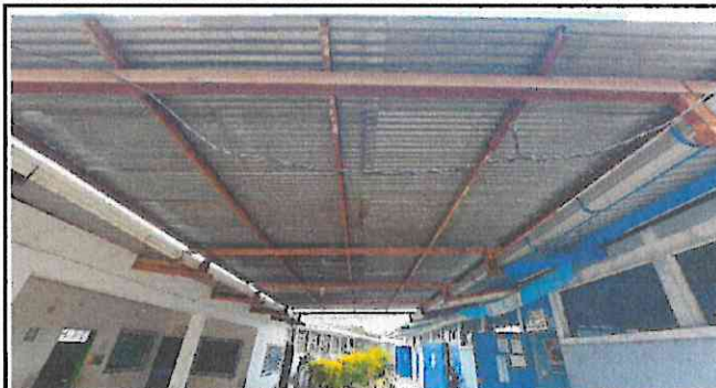
Foto 2: La lámina tiene agujeros, oxido y gotea.
